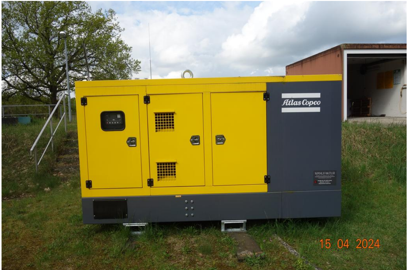
Netzersatzanlage (NEA) 2 x in Längsaufstellung
